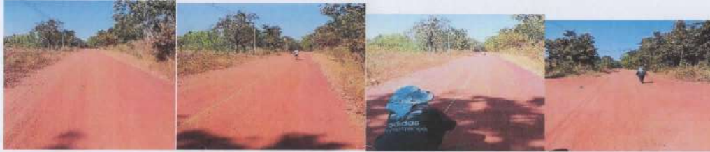
ภาพ ขณะดำเนินการ โครงการก่อสร้างถนนคอนกรีต คสล. หมู่ที่ ๒ บ้านโพนสว่าง สายบ้านโพนสว่าง ถึงบ้านวังกะเบา
